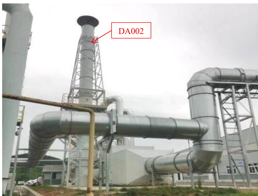
图 4-3 项目依托的厂区 2#RTO 焚化炉装置
